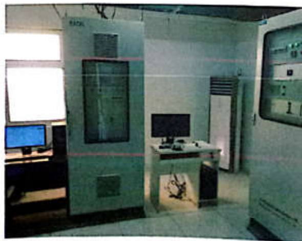
图 4-4 在线监测系统控制室
