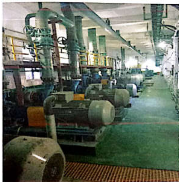
图 4-1 吸收循环系统泵房
